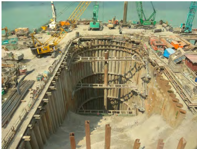
参考-14 南化ダムの土砂スルーストンネル（建設中）の流入部施工状況（現地調査時入手資料）
