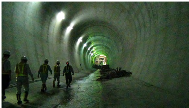
参考-13 南化ダムの土砂スルーストンネル（建設中）のトンネル内（現地調査時撮影）
