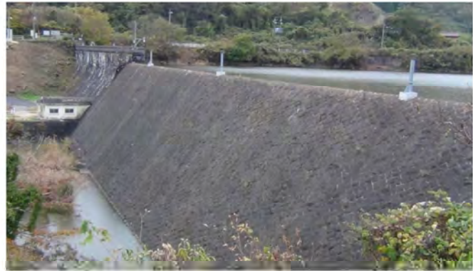
Sダム：堤体耐震補強用として2019年から国内初の堤体PSアンカーを実施予定。越流部が長いのが特徴的(越流頂の柱は光波測量用のミラー)
