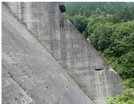
写真-1 堤体下流面および導流壁劣化状況
