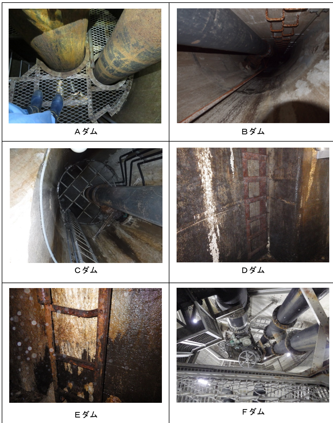
写真-5.2 階段、梯子、踊場の腐食状況
