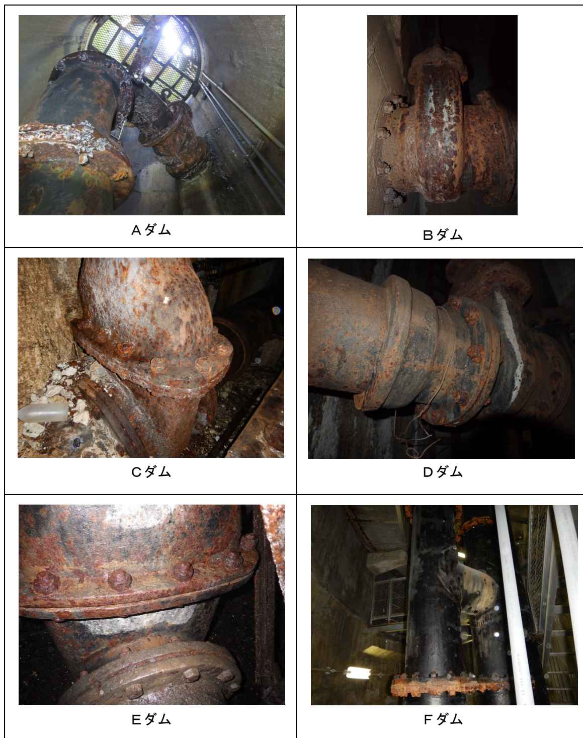
写真-5.1 ボルトの腐食状況
