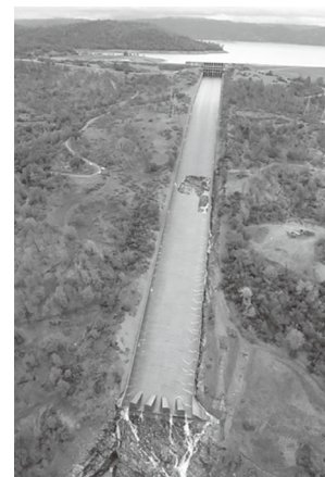
写真-3.2 常用洪水吐きの損傷状況
