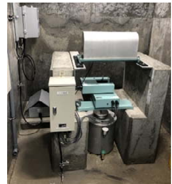
写真-1 横瀬川ダムの新設の計測本体部
