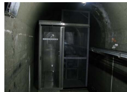
写真-2 藤原ダムの後設置の計測本体部
