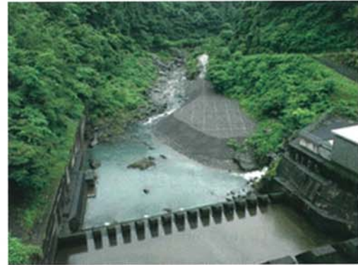
写真-8 ダム直下流の置土（洪水時の放流で侵食されて流下） 5)
