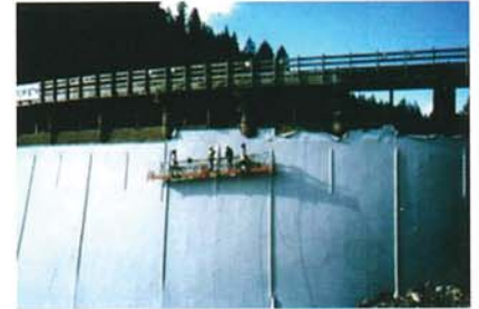
写真-2 ジオメンブレンによる漏水対策(米国) 9)
