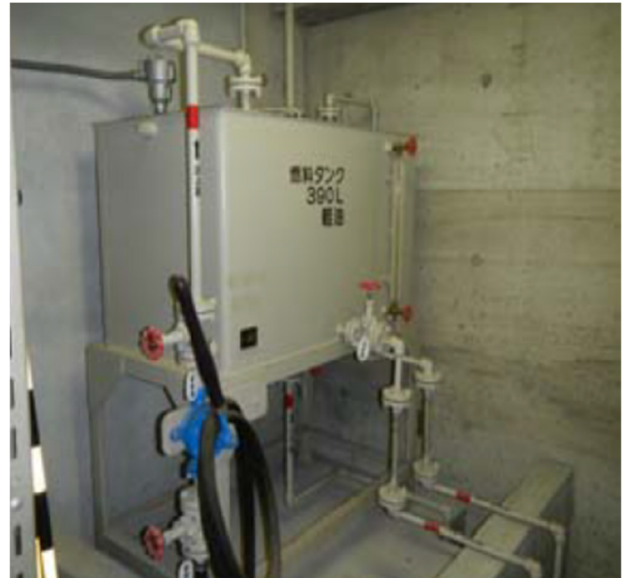
写真-2 燃料タンク
