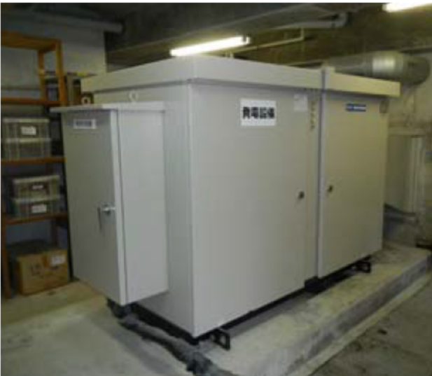
写真-1 自家発電設備
