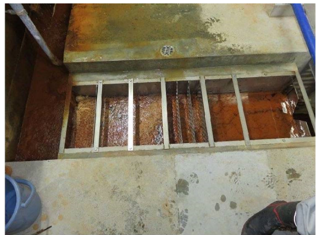
写真-1 析出物堆積状況
