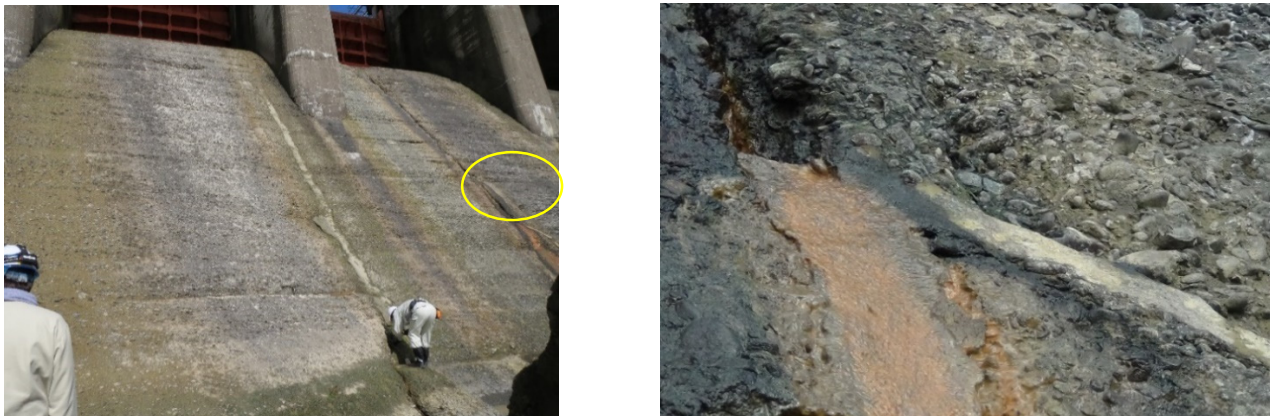
図 3 下流面の劣化状況
