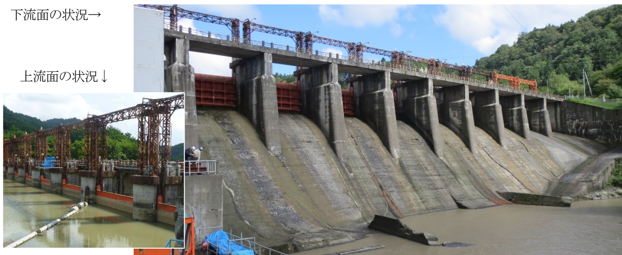
図1 清水沢ダムの補修工事前の状況（撮影 2013年9月4日）
