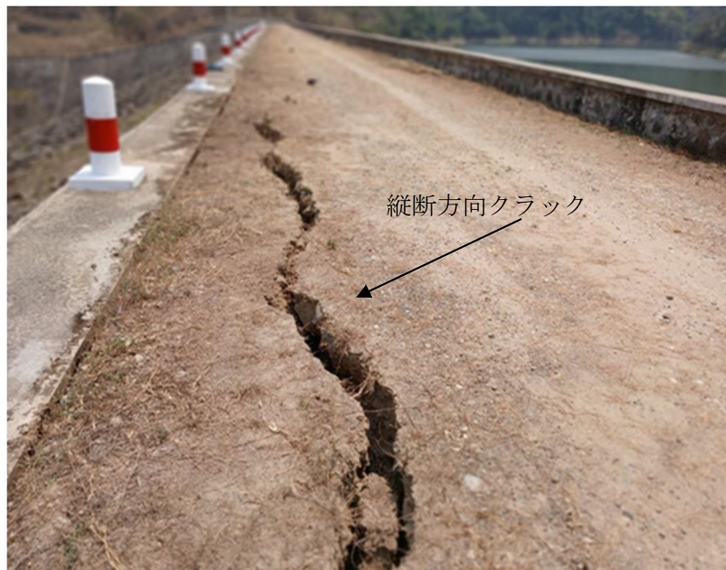
写真-3 ゾーン型ロックフィルダムである Phyu dam の堤頂部に発生した縦断方向クラック
